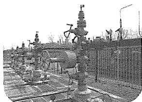
石油、天然ガスの採掘井に取り付けた地上の設備で、バルブを組み合わせた形から“クリスマスツリー”と呼ばれている
